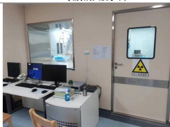
DSA 机房控制室
