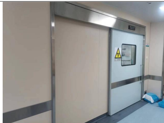
DSA 机房病人防护门
